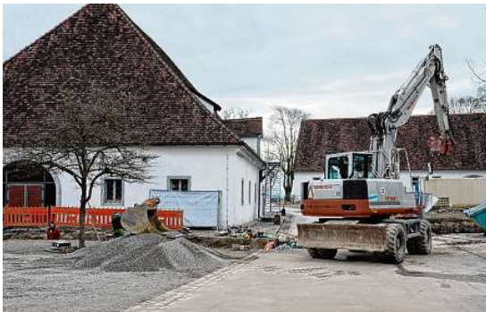
Bagger und Baugruben zeugen von den großen Umbauarbeiten. Im Hintergrund ist die Reithalle zu sehen, die in eine zweite Sporthalle umgewidmet wurde. BILDER: JENNA SANTINI (3)
